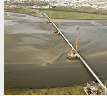
Construcción de los cofferdam del puente de Mersey. Fernando Flores. Cofferdam construction in the Mersey Bridge.UK
